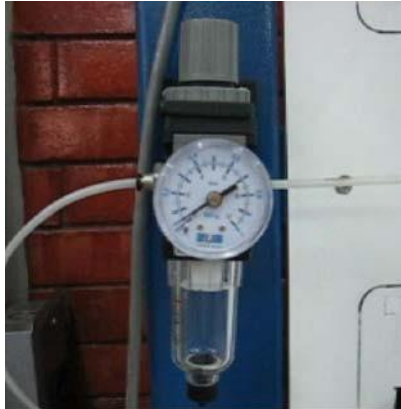
Figura 3.6: Filtro regulador de presión.
