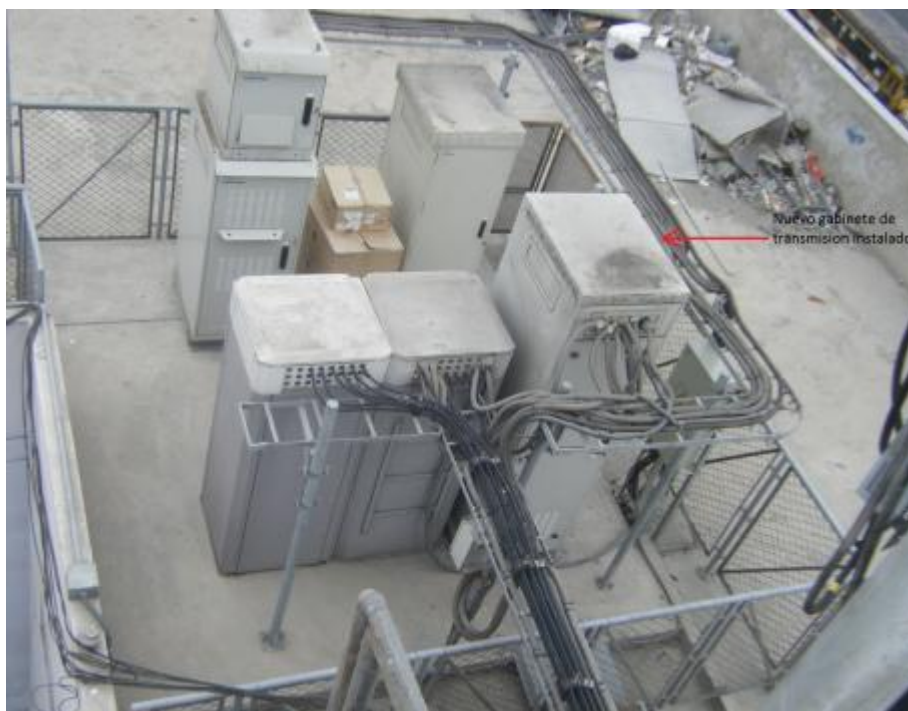
Foto 2. Gabinete de transmisión instalado
