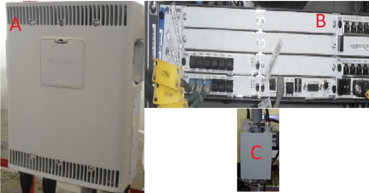
Foto 6. Equipos HUAWEI utilizados en la instalación
