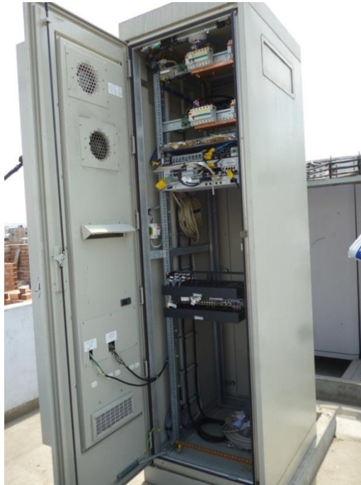
Foto 8. BBU+DCDU instalado en el gabinete de transmisión
