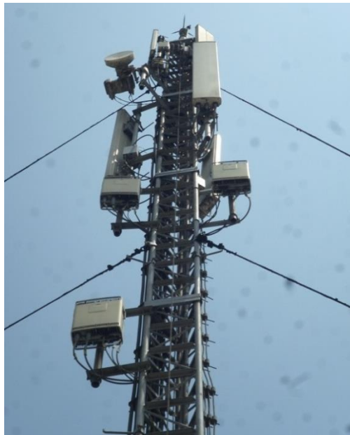
Foto 9. RRU + antenas + filtro instalados en torre
