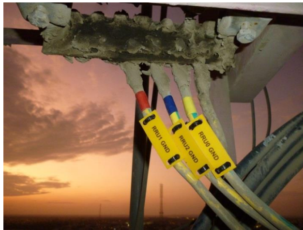
Foto 11. RRU aterradas a barra de tierra
