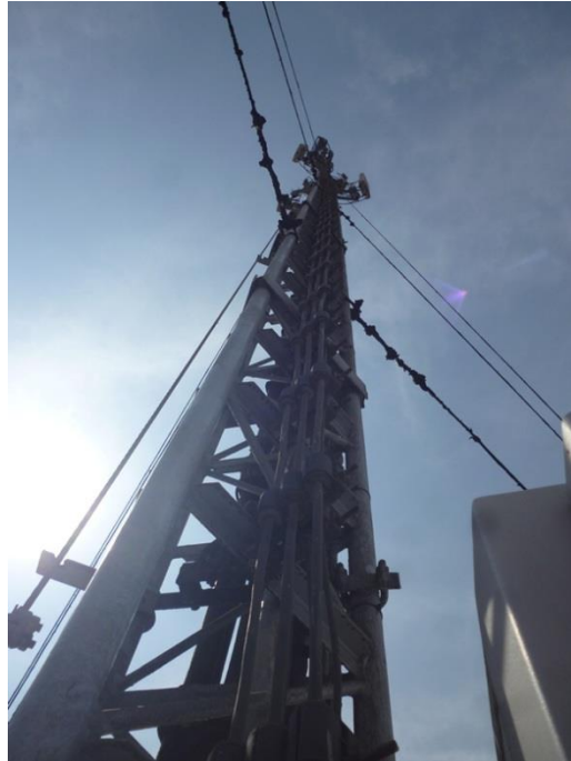
Foto 10. Recorrido en torre de cables de energía y fibra óptica
