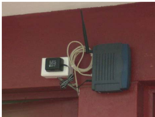
Figura 19: Foto de access point instalado al aire libre en la Unidad Minera expuesto a cortos circuitos por las lluvias.
