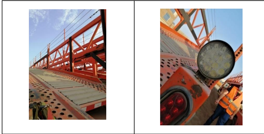
Figura 90: Registros de fallas mecánicas Fuente: Empresa Schiappacasse Perú
