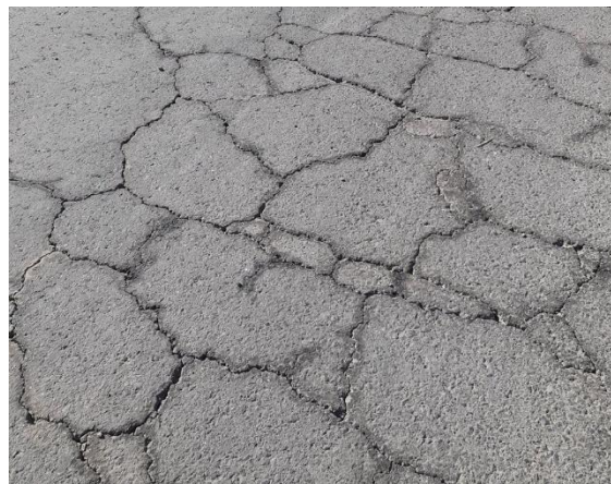
Figura 20. Fisuración por fatiga.
