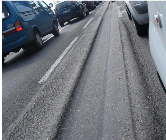
Figura 19. Ahuellamiento en pavimentos.
