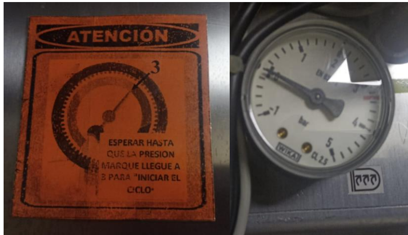
Figura N 49: Control visual de presión de aire comprimido - Matachana Fuente: Centro oftalmológico
