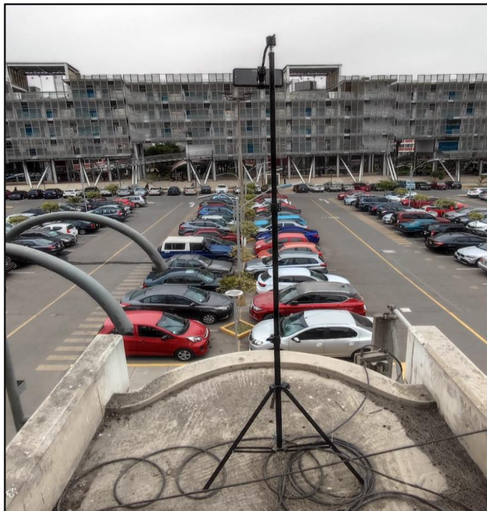
Figura N 5: Instalación de cámara en la garita de la puerta 3 del estacionamiento de la Universidad Ricardo Palma Fuente: Elaboración propia
