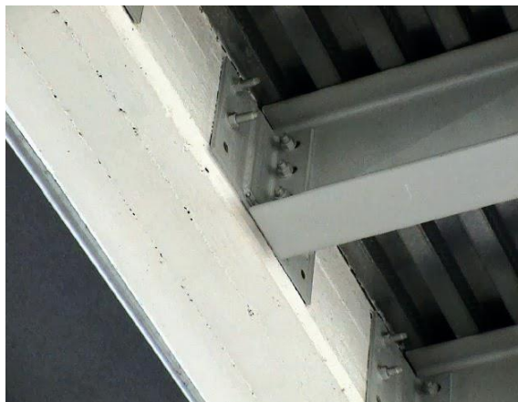
Figura N°8: Fijación de una viga de acero sobre una viga de hormigón Fuente: Pierre, E. (2013)
