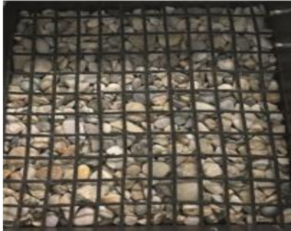
Figura 19: Fijación de la geomalla en el área de cizallamiento antes de colocar y compactar
