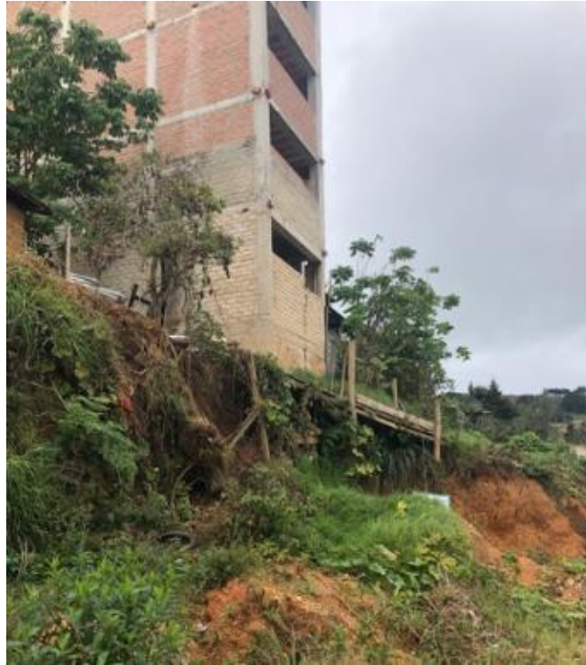
Figura 4. Presencia de suelo arcilloso en urbanización Barrio Niño Dios
