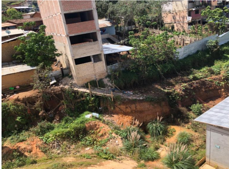
Figura 35. Tramo de talud arcilloso por contener
