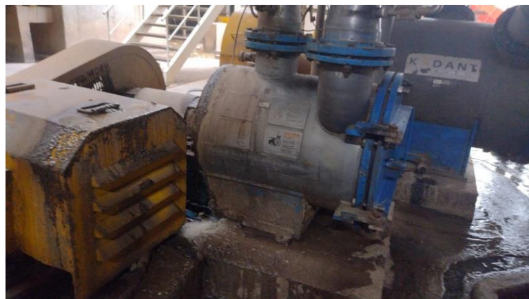
Figura 4: Fallo del rodamiento Fuente: Área de mantenimiento – Papelera del Sur S.A. Elaboración: Propia
