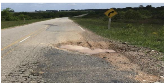
Figura 11. Falla producida por la humedad Fuente: Bitafal
