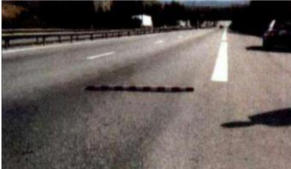
Figura 8: Ahuellamiento en un pavimento flexible con un nivel de severidad bajo
