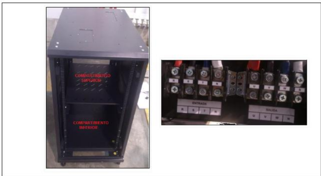
Figura 8: Gabinete eléctrico y borneras
