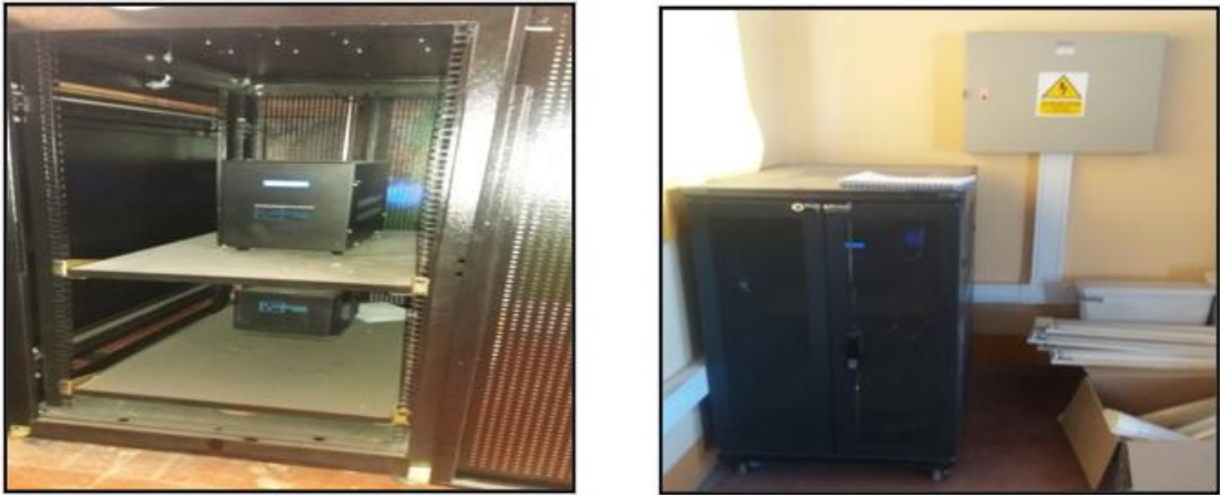
Figura 9: Gabinete eléctrico Fuente: informe del proyecto
