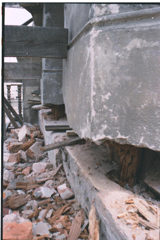
Fig. Nro. 44.- Falla por corte de pilares, para esfuerzos superiores a 0.70 \text{ kg/cm}^2 según el diagrama de esfuerzos, nótese las piezas de madera dentro de los pilares de ladrillo.
