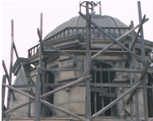
Fig. Nro. 43.- Esfuerzos en la zona de pilares y cúpula, nótese que esfuerzos de tracción superiores a 0.50 kg/cm 2 fracturaron los cimborrios y ocasionaron desprendimientos, lo que obligo al apuntalamiento de todos los arcos de esta zona.
