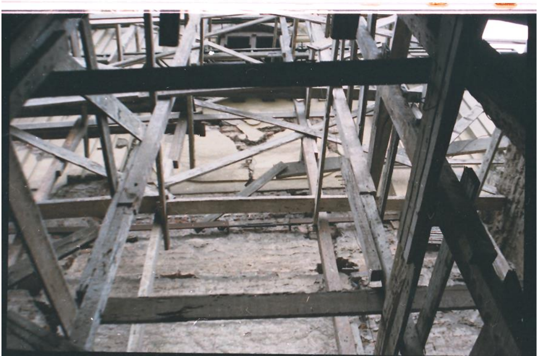
Fig. Nro. 17.- Fotografía que muestra los daños en la cara Este de la Torre,
