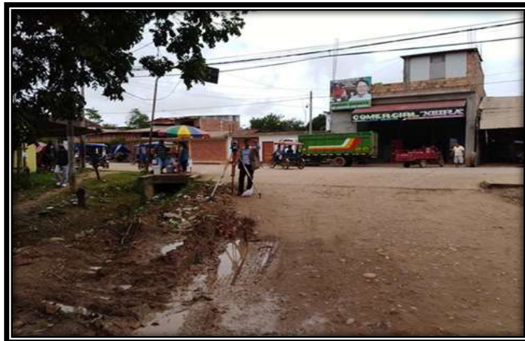
Figura 21: Aniego formado en el inicio del tramo por la falta de cunetas, situación que deteriorará su estado
