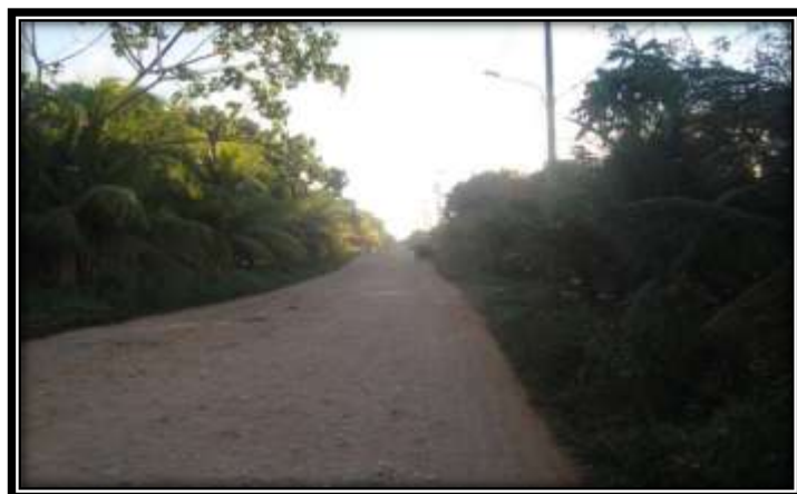
Figura 29: Deterioro en el recorrido de la capa de rodadura, totalmente encalaminada, ahuellada y con escaso drenaje
