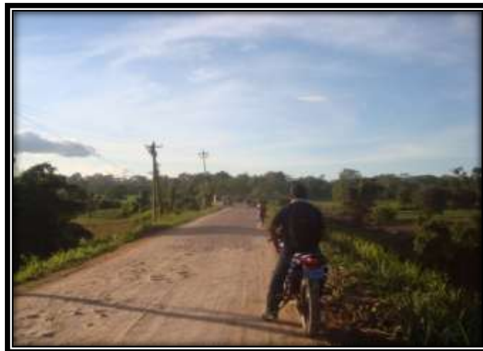
Figura 25: La topografía plana del lugar y el deterioro de la capa de rodadura, totalmente encalaminada, ahuellada y con escaso drenaje
