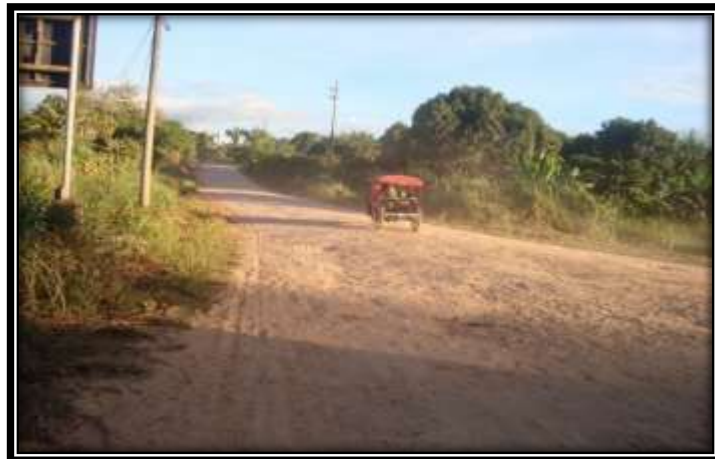
Figura 28: Otra vista del estado calamitoso de la vía
