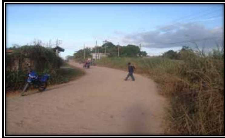
Figura 22: Deterioro de la capa de rodadura, totalmente encalaminada, ahuellada y con escaso drenaje
