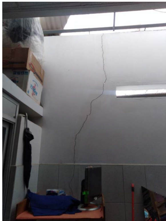
Figura 11: Rajadura de muro perimetral en R14
