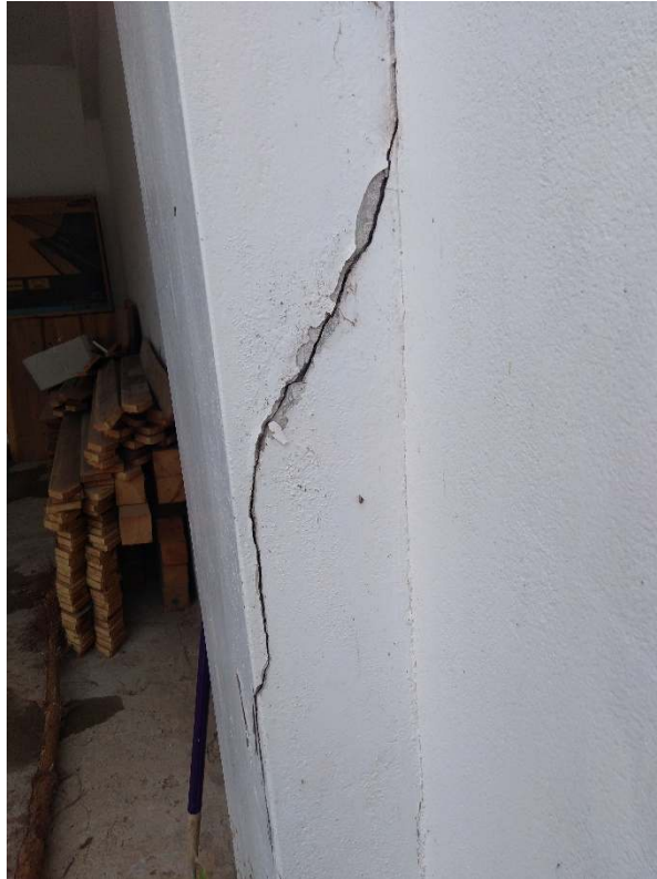
Figura 12: Grieta de columna en R18
