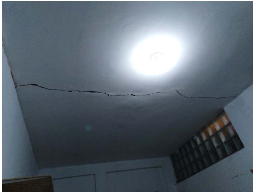
Figura 8: Rajadura de techo de R1.
