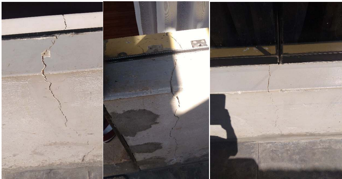
Figura 9: Grieta de parapetos de R13
