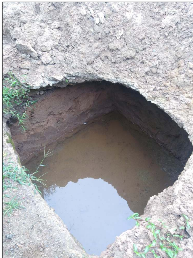
Figura 35: Suelo desmoronado luego de excavación
