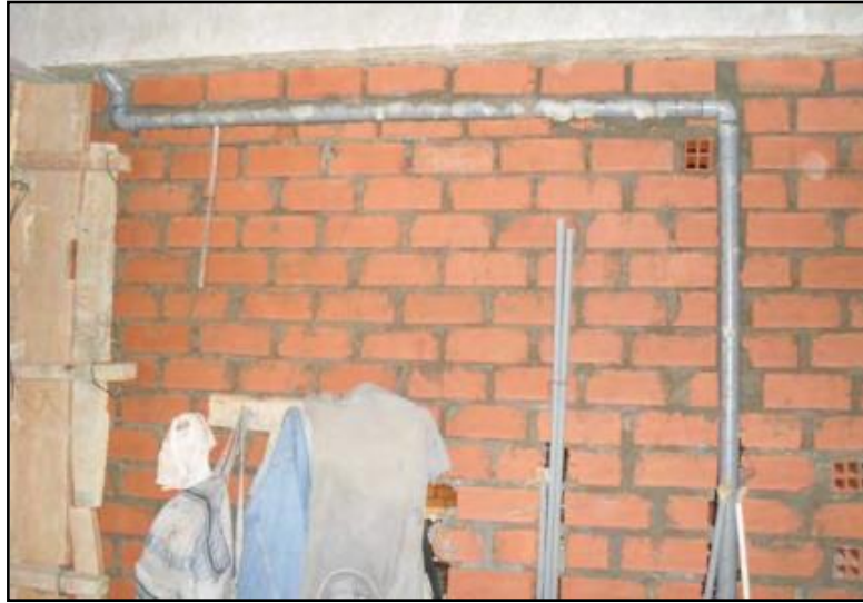
Figura N° 1. Tabique cortado en dos de sus extremos de confinamiento, superior y lateral Fuente: Lengua (2013)
