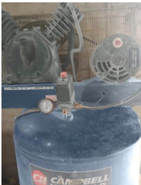
Figura 33. Estado de compresor mediante mantenimientos continuos
