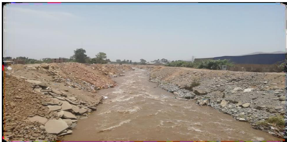
Figura 5 Residuos de demolición en el cauce del río Chillón
