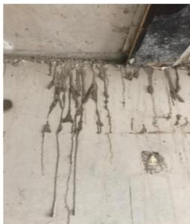
Figura 26 Ejemplo de muro con escurrimiento de lechada ya endurecida Fuente: Leal (2020)
