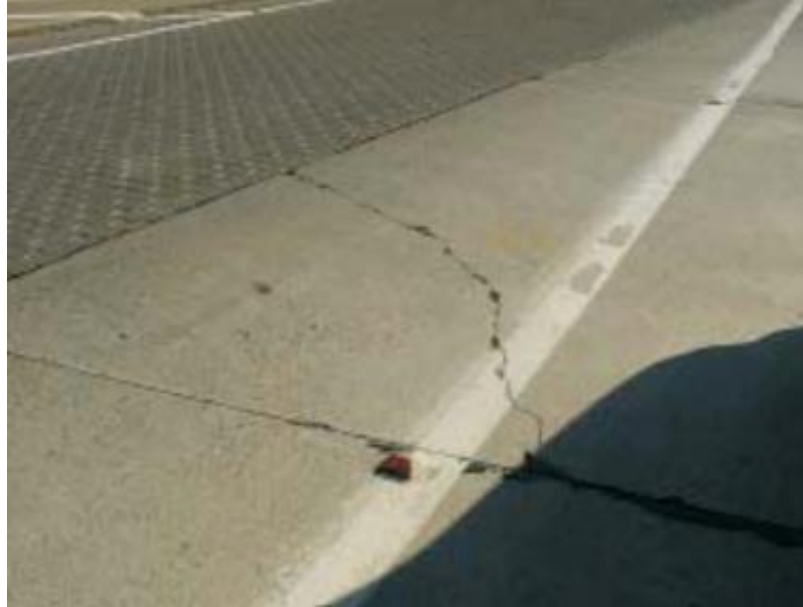
Figura N° 52: Fisuración en Pavimentos hidráulicos.
