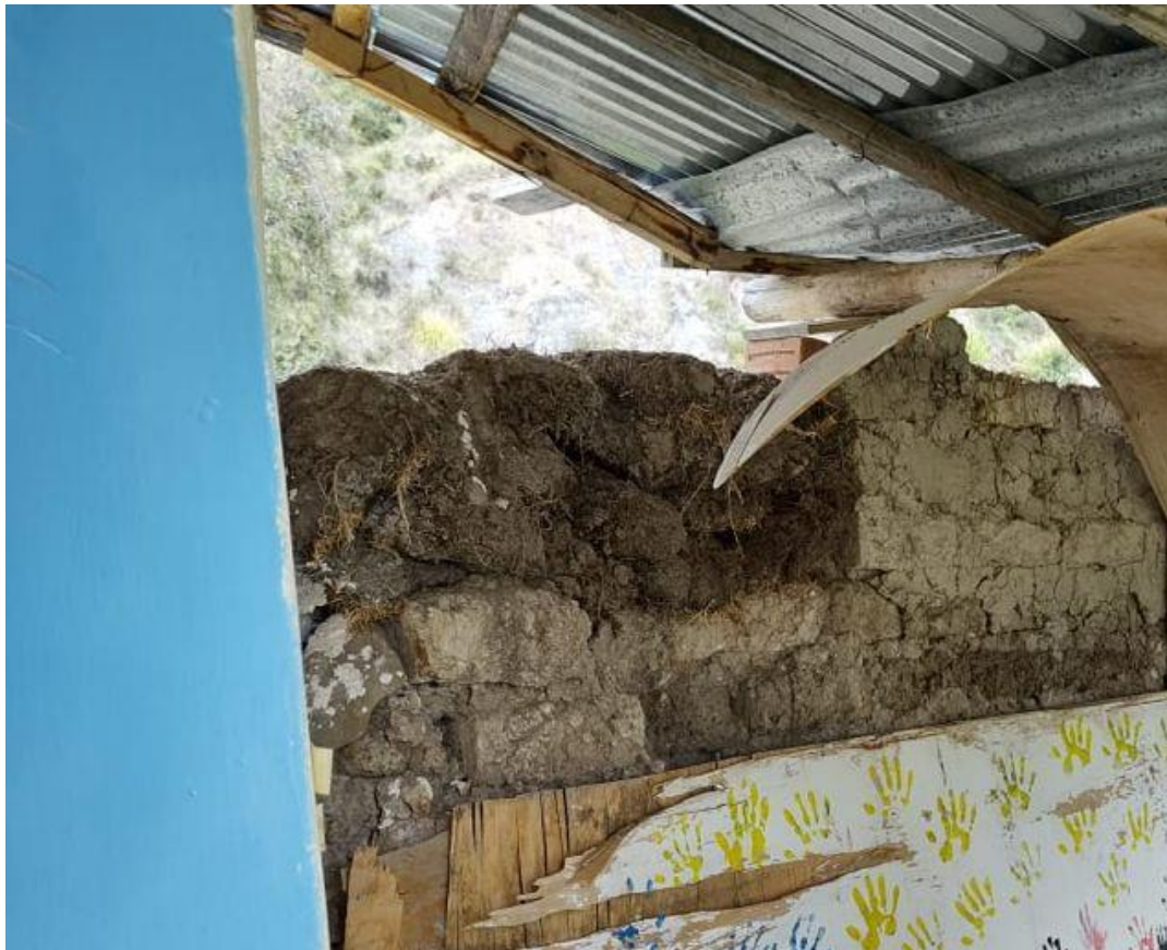
Figura 3: Colegio con pared de adobe y techo de calamina en Víctor Fajardo
