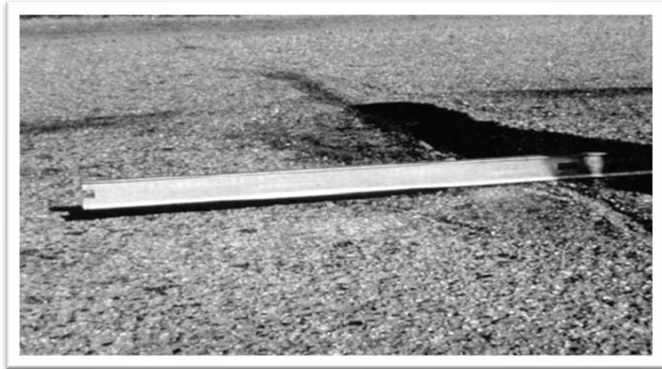
Figura N°17: Severidad baja en abultamientos (L) Fuente: American Society for Testing and Materials, 2018
