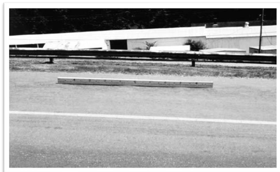
Figura N°21: Severidad media en corrugación (M)
