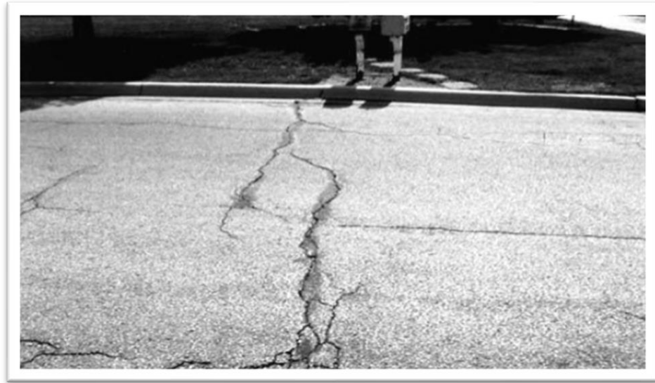
Figura N°15: Severidad Media de fisuras en bloque (M) Fuente: American Society for Testing and Materials, 2018
