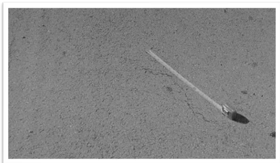
Figura N°51: Fisuras parabólicas por deslizamiento de Severidad Baja (L) Fuente: American Society for Testing and Materials, 2018
