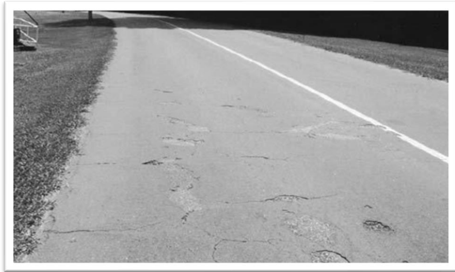
Figura N°57: Peladura por intemperismo y desprendimiento de agregados de Severidad Alta (H)
