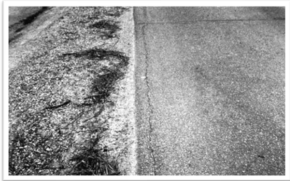
Figura N°26: Fisuras de borde con Severidad Baja (L) Fuente: American Society for Testing and Materials, 2018
