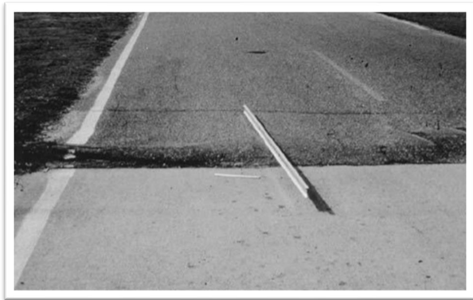
Figura N°50: Desplazamiento de Severidad Alta (H) Fuente: American Society for Testing and Materials, 2018
