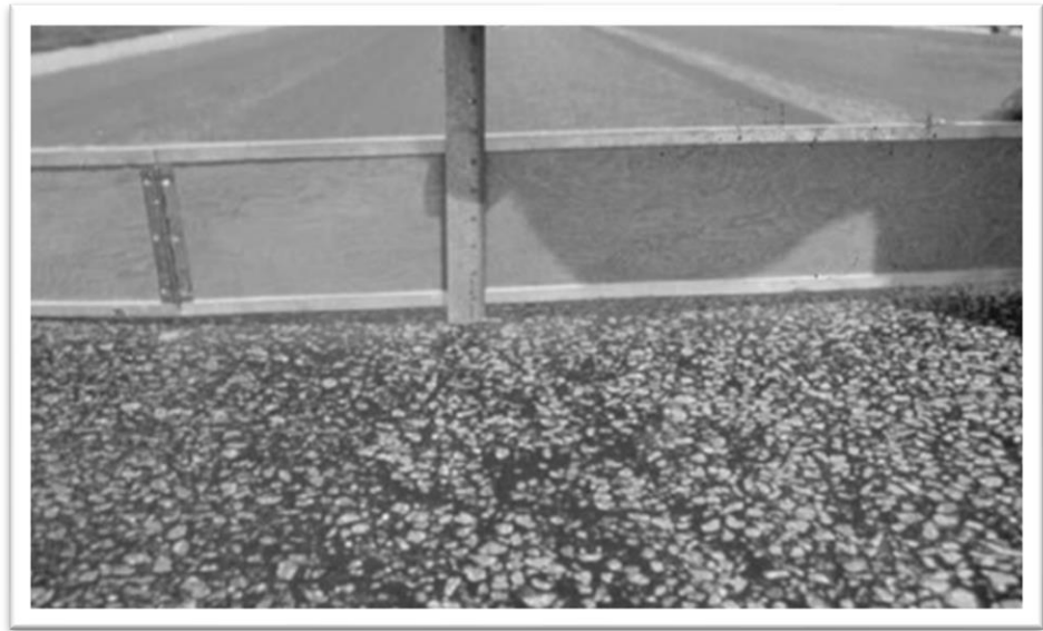
Figura N°46: Ahuellamiento de Severidad Media (M) Fuente: American Society for Testing and Materials, 2018
