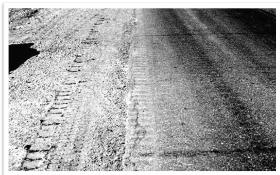
Figura N°29: Fisuras de Reflexión de Junta de Severidad Baja (L) Fuente: American Society for Testing and Materials, 2018
