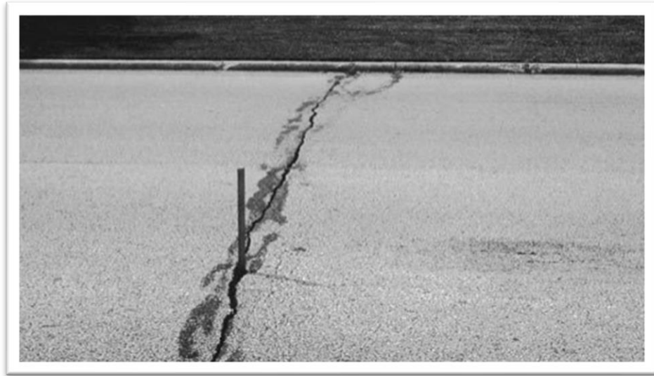
Figura N36: Fisuras Longitudinales y Transversales con Severidad Media (M) Fuente: American Society for Testing and Materials, 2018
