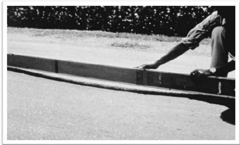
Figura N°24: Depresión con severidad Media (M) Fuente: American Society for Testing and Materials, 2018
