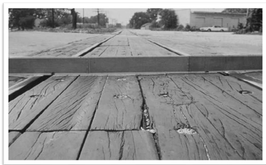
Figura N°58: Cruce de Vía Férrea de Severidad Baja (L)
