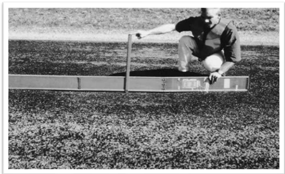
Figura N°25: Depresión con Severidad Alta (H) Fuente: American Society for Testing and Materials, 2018
