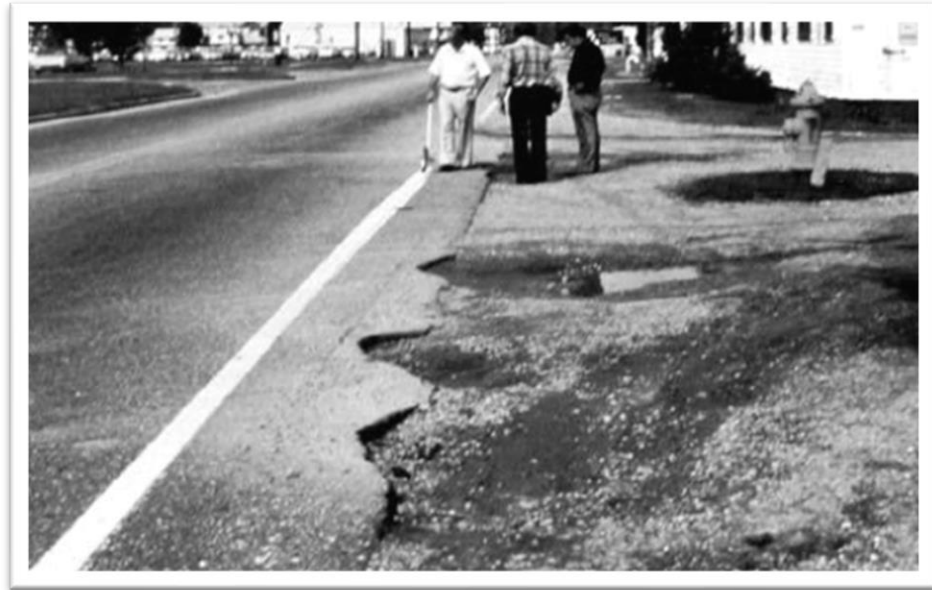
Figura N°28: Fisuras de borde con Severidad Alto (H) Fuente: American Society for Testing and Materials, 2018
