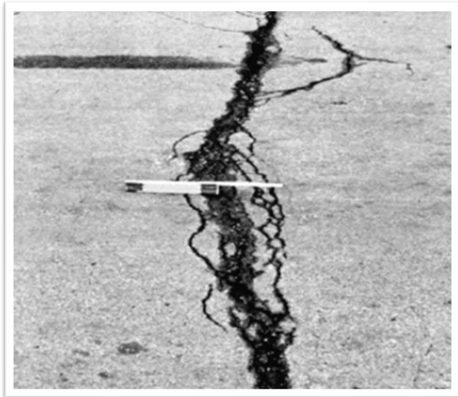
Figura N°31: Fisuras de Reflexión de Junta de Severidad Alta (H) Fuente: American Society for Testing and Materials, 2018
