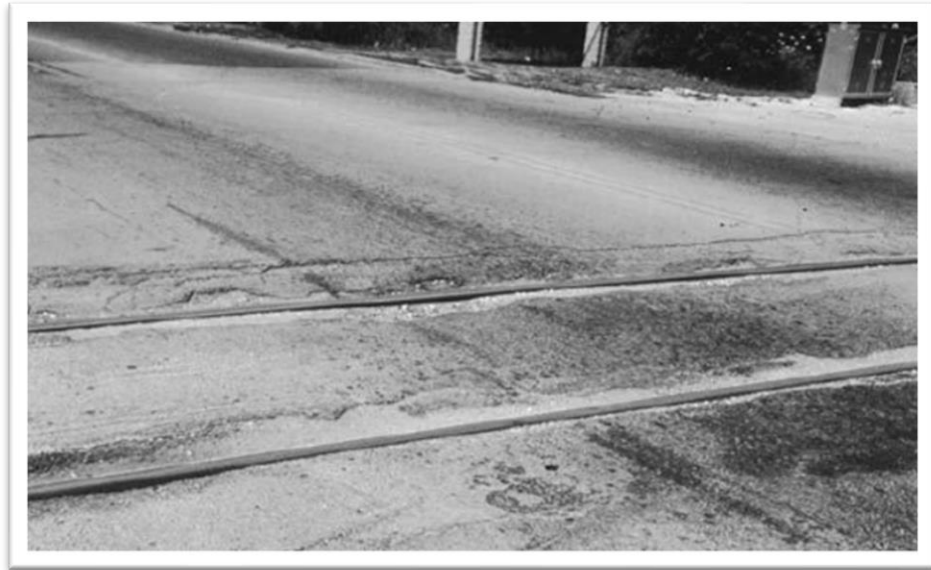
Figura N°59: Cruce de Vía Férrea de Severidad Media (M) Fuente: American Society for Testing and Materials, 2018
