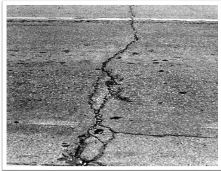
Figura N°30: Fisuras de Reflexión de Junta de Severidad Media (M) Fuente: American Society for Testing and Materials, 2018
