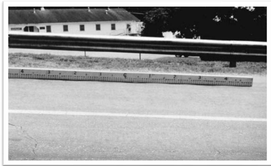
Figura N°20: Severidad baja en corrugación (L)
