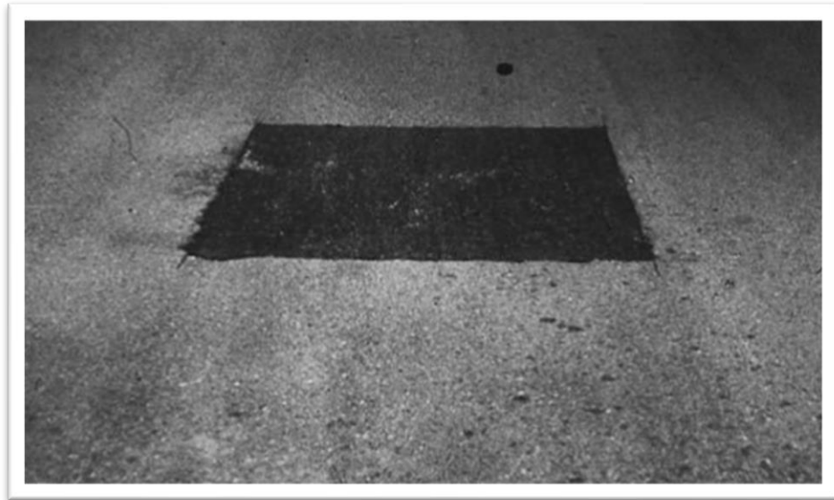
Figura N°38: Parches y Cortes Utilitarios de Severidad Baja (L) Fuente: American Society for Testing and Materials, 2018
