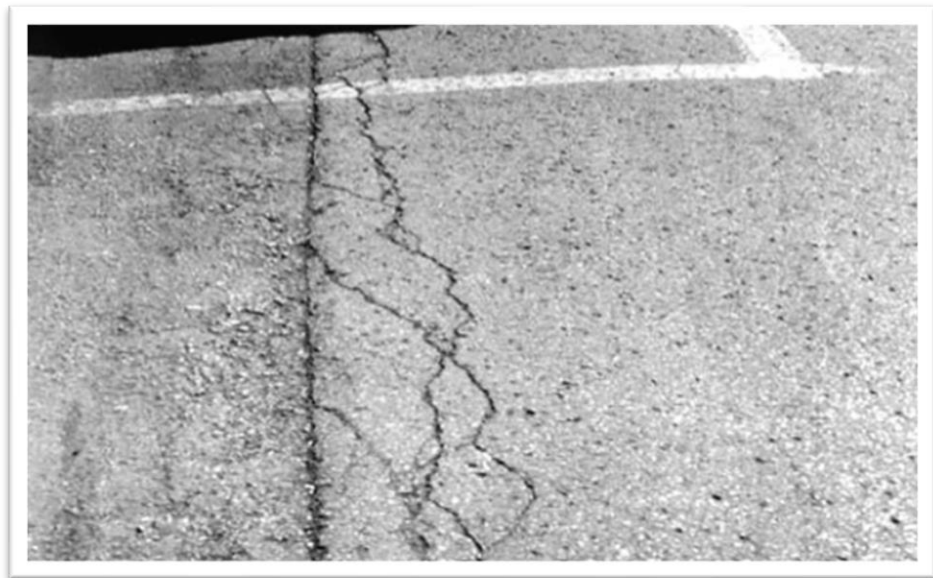
Figura N°27: Fisuras de borde con Severidad Medio (M) Fuente: American Society for Testing and Materials, 2018
