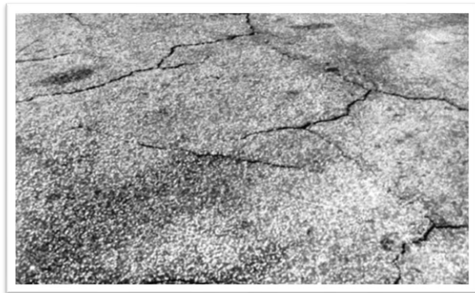
Figura N°16: Severidad Alta de Fisuras en Bloques (H) Fuente: American Society for Testing and Materials, 2018
