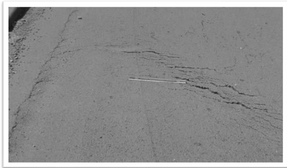
Figura N°52: Fisuras parabólicas por deslizamiento de Severidad Media (M) Fuente: American Society for Testing and Materials, 2018
