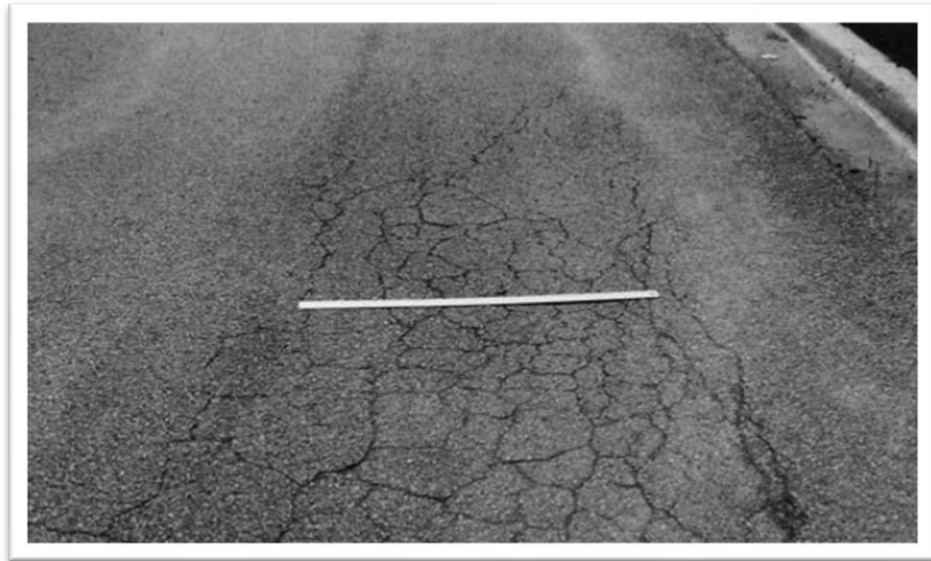
Figura N°9: Severidad Media de piel de cocodrilo (M) Fuente: American Society for Testing and Materials, 2018
