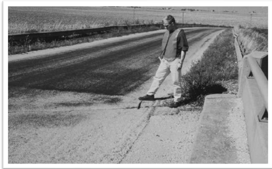
Figura N°48: Desplazamiento de Severidad Baja (L)
