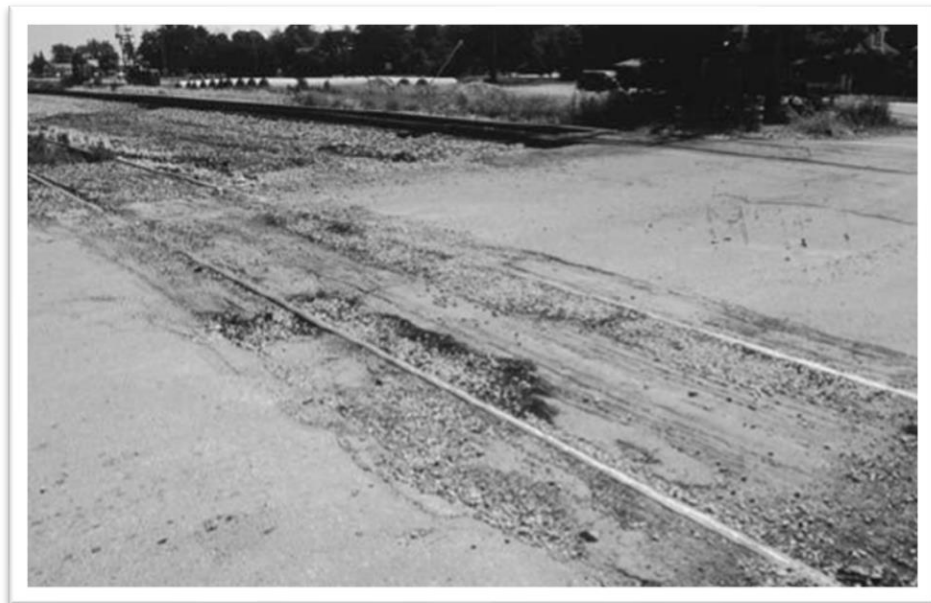
Figura N°60: Cruce de Vía Férrea de Severidad Alta (H) Fuente: American Society for Testing and Materials, 2018
