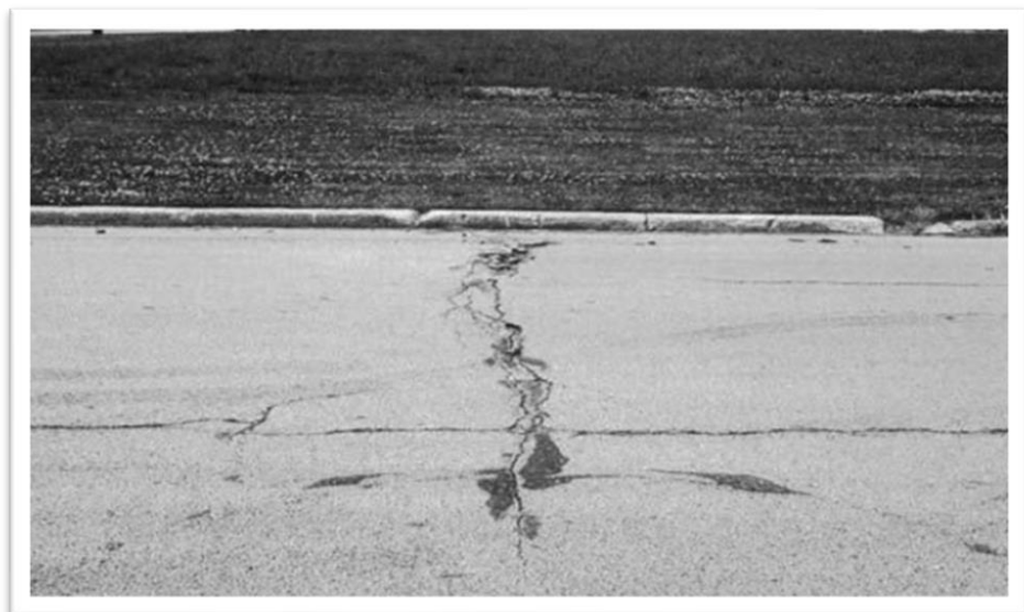
Figura N°37: Fisuras Longitudinales y Transversales con Severidad Alta (A) Fuente: American Society for Testing and Materials, 2018
