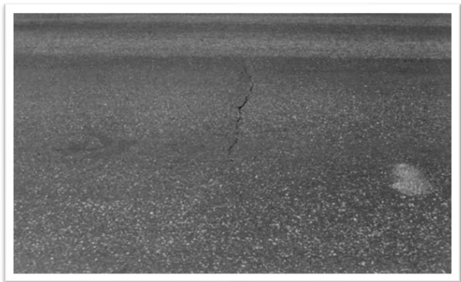
Figura N°35: Fisuras Longitudinales y Transversales con Severidad Bajo (L) Fuente: American Society for Testing and Materials, 2018
