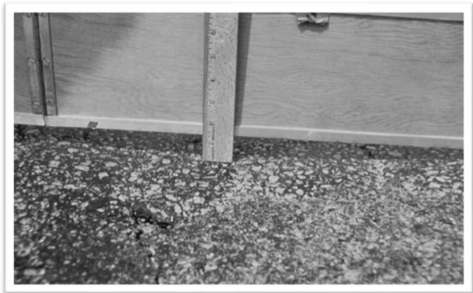
Figura N°47: Ahuellamiento de Severidad Alta (H) Fuente: American Society for Testing and Materials, 2018
