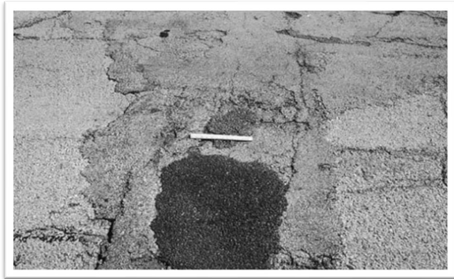
Figura N°40: Parches y Cortes Utilitarios de Severidad Alta (H). Fuente: American Society for Testing and Materials, 2018.
