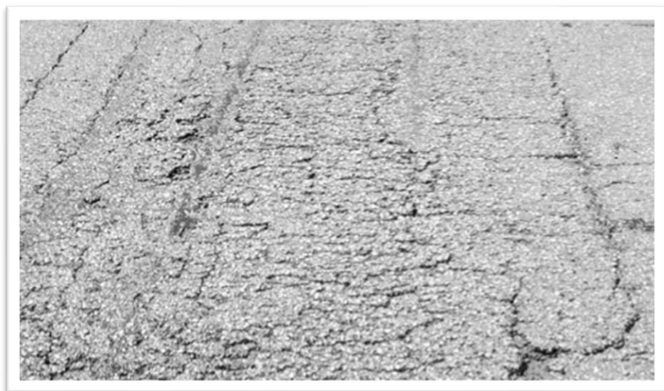
Figura N°56: Peladura por intemperismo y desprendimiento de agregados de Severidad Media (M)
