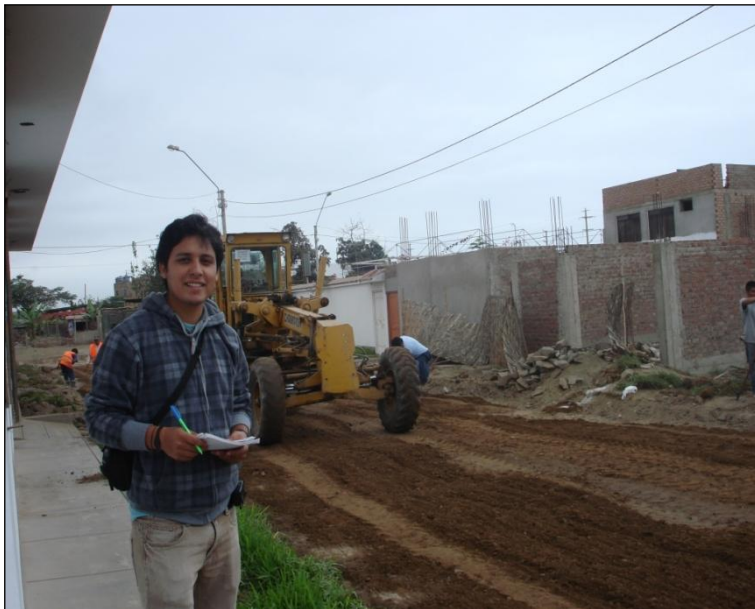
Imagen 27- Motoniveladora escarificando y mezclando el material para mejoramiento de la sub rasante
