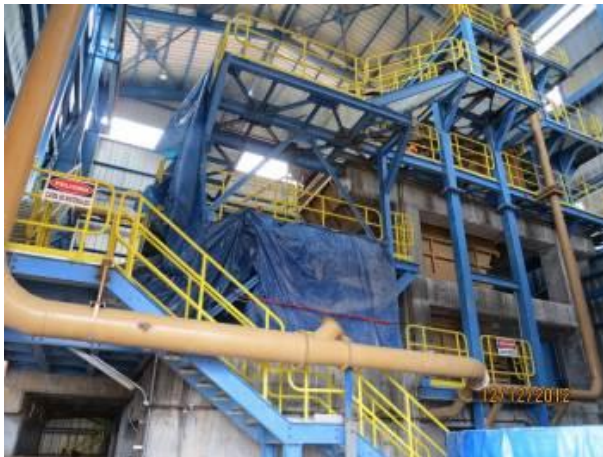
Colector de polvo en ECHS, terminado
