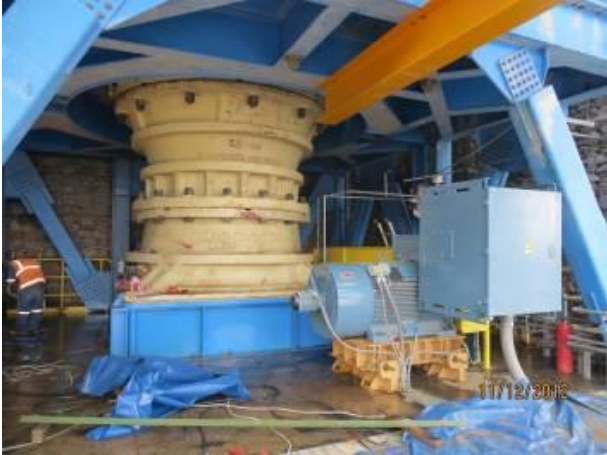
Equipo de CHP: Terminado y Probado en vacio y con carga
