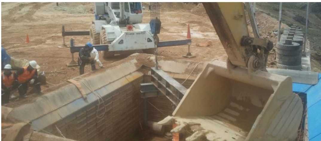
Imagen N°33: Zona de descarga de la planta de Chancado Primario.
