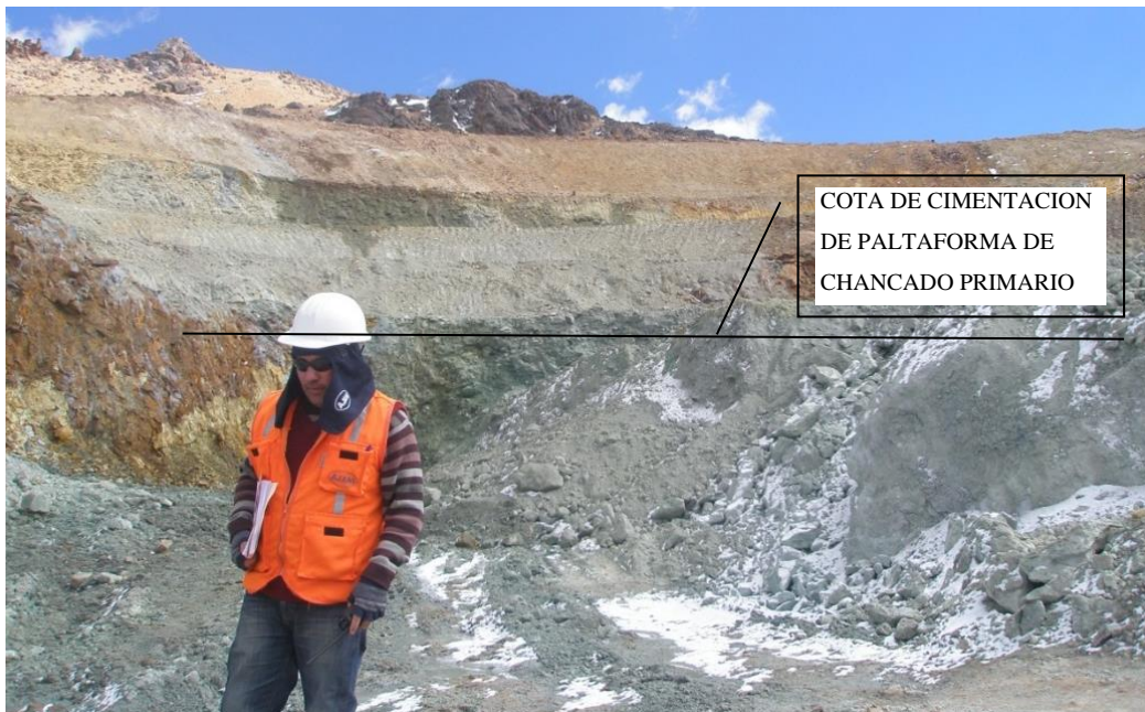
Imagen N°20: Sobre-excavación ya que no se encontró roca fracturada para la cimentación de la zapata (se encontró material argilizado-sulfuros en proceso de degradación), que excavo hasta el nivel 4936.00
