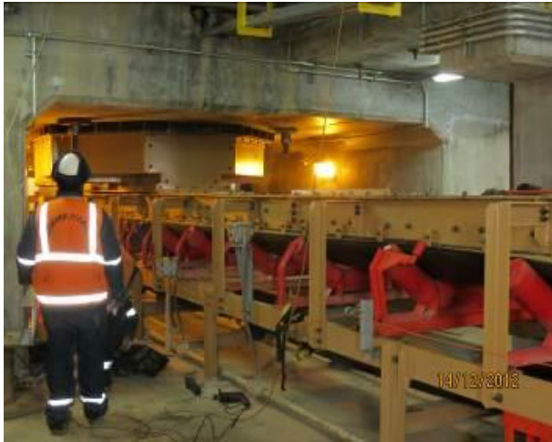
Faja CV-05: Probado de luminarias
