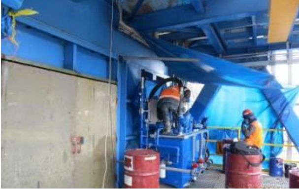
Unidad Hidraulica de CHP, terminado y probado en vacio y con carga
