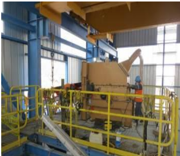
Tolva de descarga de Faja CV-02
