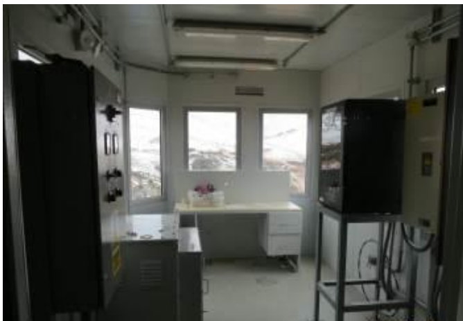
Sala de Control de CHP, al interior, terminado conexionado.
