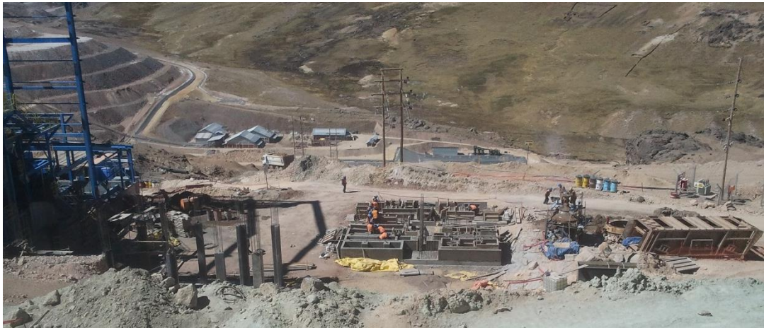
Imagen N°34: Vista de los trabajos de albañilería de la sala eléctrica y patio de llaves.
