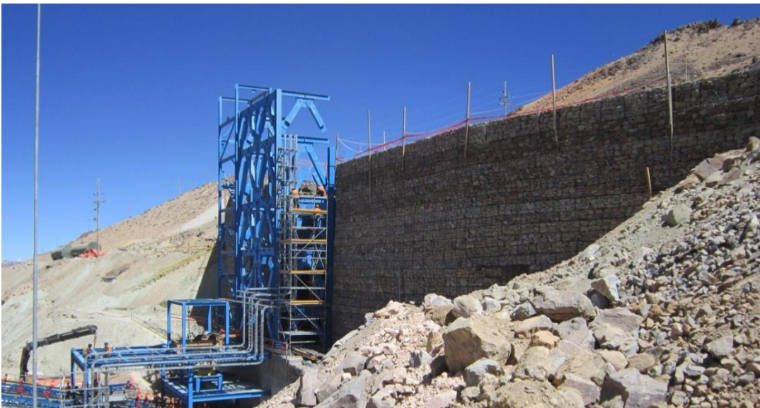
Imagen N°25: Muro de gaviones y el edificio de estructura metálicas para soporte del sistema de chancado primario.
