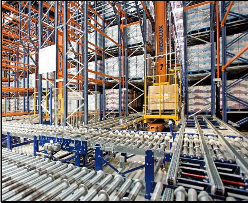
Figura 11. Almacenamiento Transelevadores tipo Silo.
