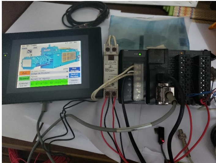
Figura N° 68 Verificación de Señales de entrada en el PLC
