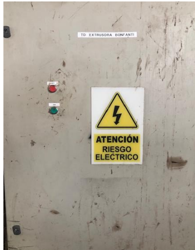
Figura N° 27 Tablero de Fuerza de Motor Principal
