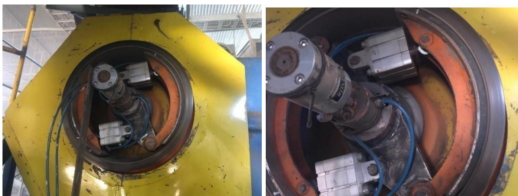
Figura N° 40 Acoplamiento Neumático del Motor con Reductor
