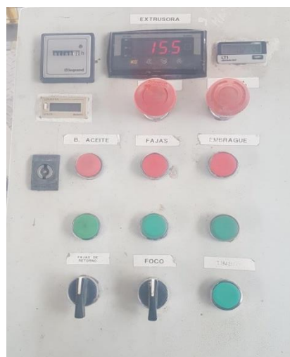
Figura N° 28 Tablero de Control de Extrusora
