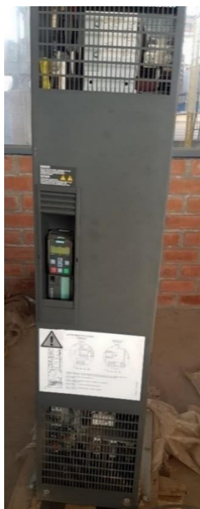
Figura N° 44 Variador de Frecuencia de 200KW
