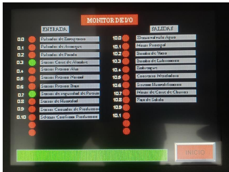
Figura N° 71 Verificación de señales en pantalla HMI
