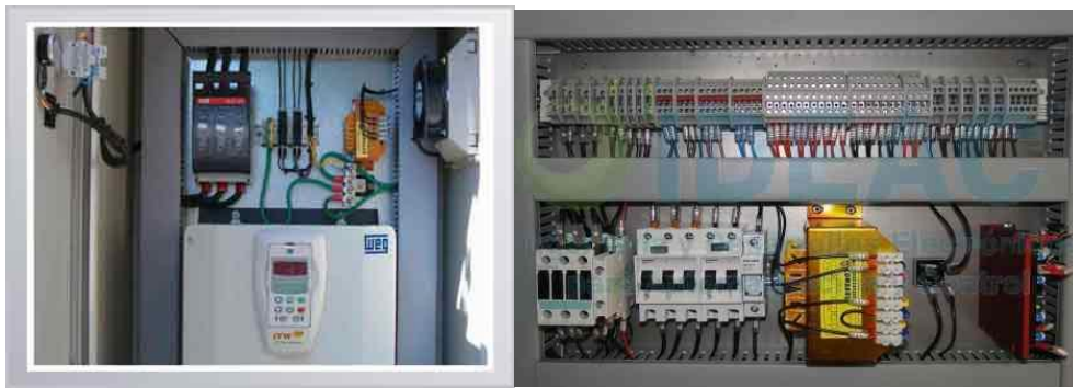
Figura N° 41 Tablero de Eléctrico de Control
