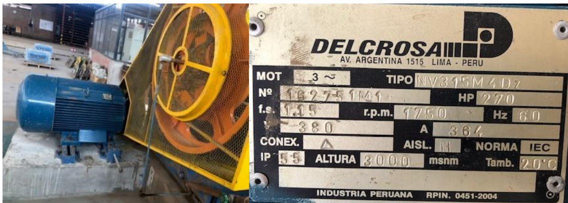
Figura N° 29 Motor Eléctrico Principal
