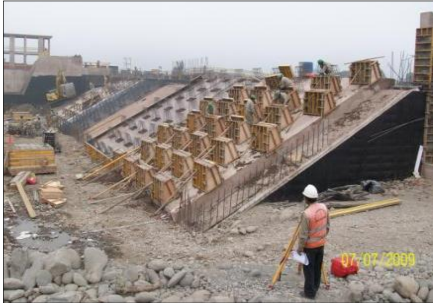
Figura 50: Encofrado de dados de disipación en Aliviadero Fijo Fuente: Registro Fotográfico de Obra
