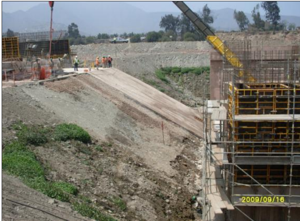
Figura 38: Solado en Vertedero
