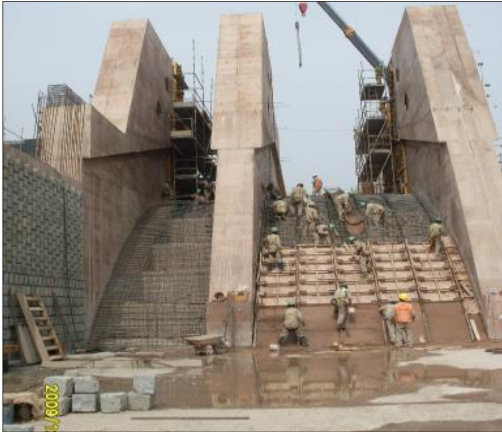
Figura 43: Vaciado de Segunda Etapa de Losa de Aliviadero Fuente: Registro Fotográfico de Obra
