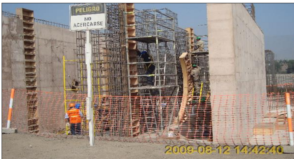
Figura 30: Estructura de Regulación de la Captación
