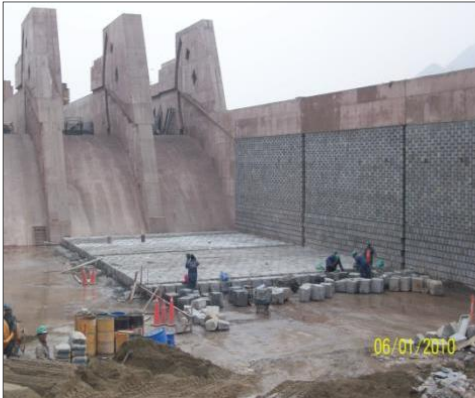
Figura 44: Enchape de Piedra Labrada en Poza de Disipación Fuente: Registro Fotográfico de Obra
