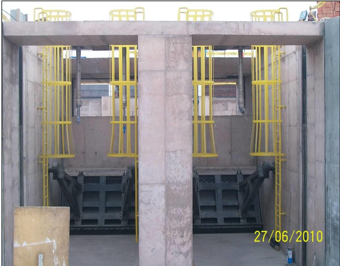
Figura 14: Vista de las Compuertas Radiales de Captación Fuente: Registro Fotográfico de Obra
