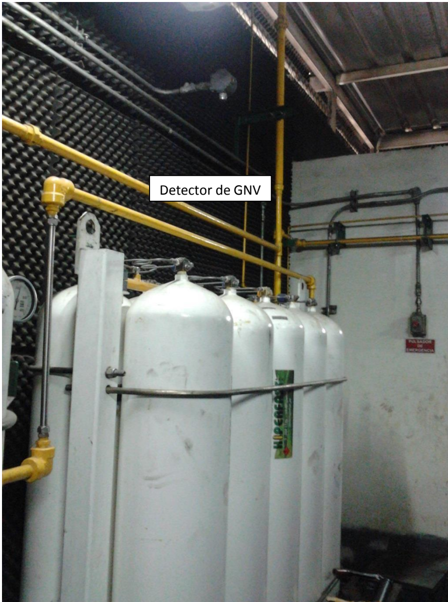
Figura 1.3 Detector de GNV en recinto de compresión.
