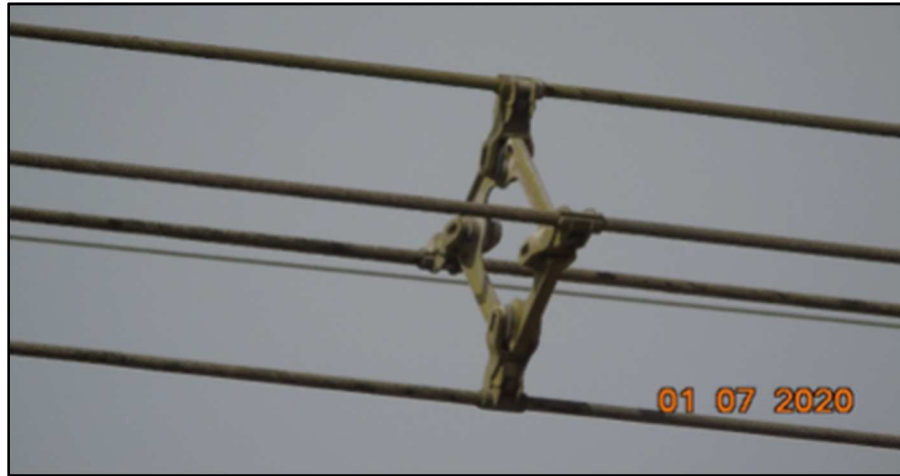
Figura 6: Cuatro conductores con separador
