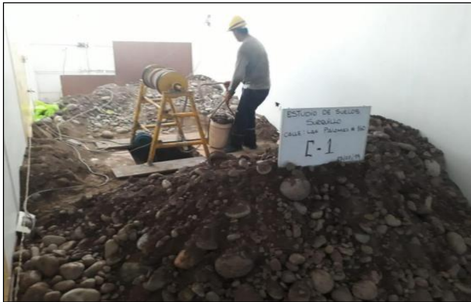
FOTO N° 4: Otra vista panorámica exterior de la excavación a cielo abierto denominado calicata C-1.
