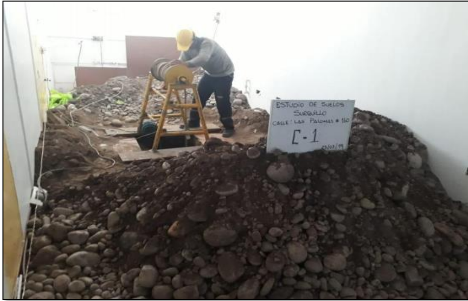
FOTO N° 3: Vista panorámica exterior de la excavación a cielo abierto denominado calicata C-1.
