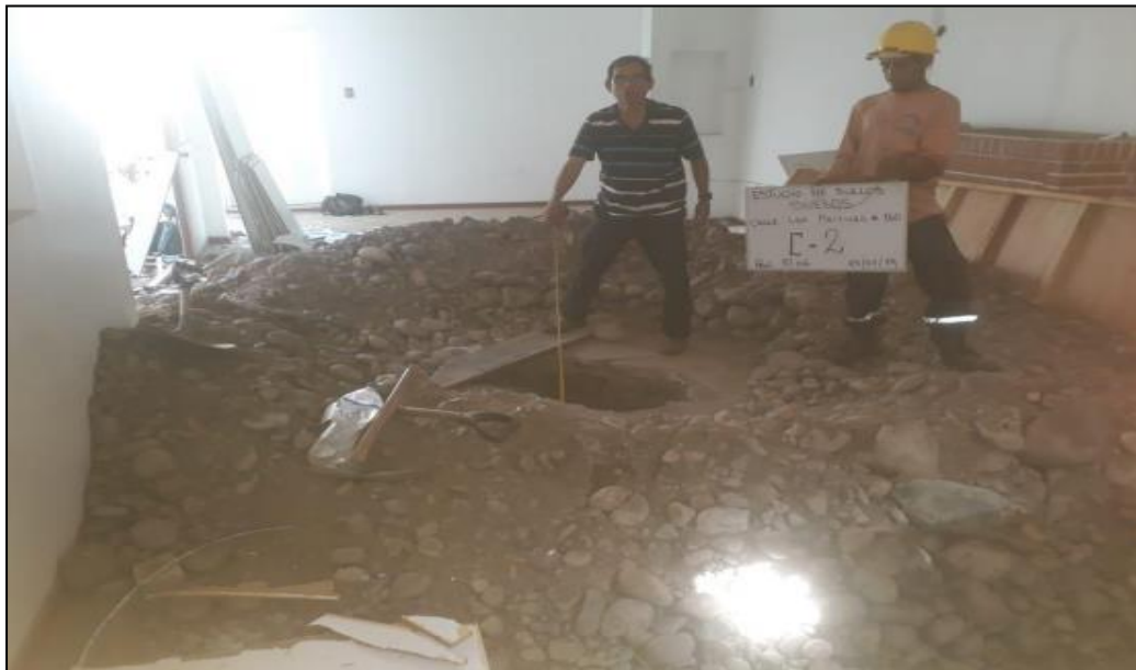
FOTO N° 7: Vista panorámica exterior de la excavación a cielo abierto denominado calicata C-2.
