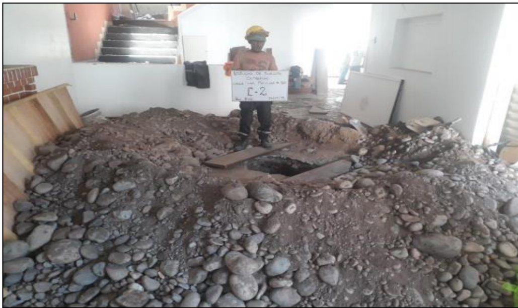
FOTO N° 8: Otra vista panorámica exterior de la excavación a cielo abierto denominado calicata C-2.
