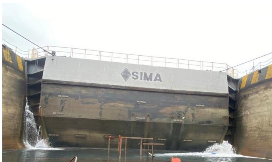
Figura 16. Pase de agua de la compuerta del dique seco
