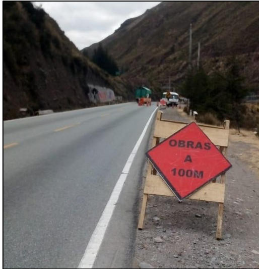
Figura 22: Señalización de área de protección
