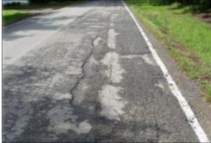
Figura N° 24: Desprendimiento de agregados
