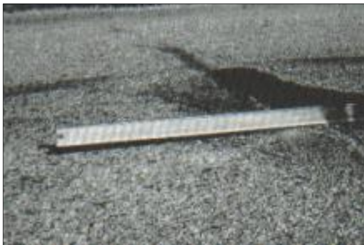
Figura N° 9: Abultamientos y hundimientos
