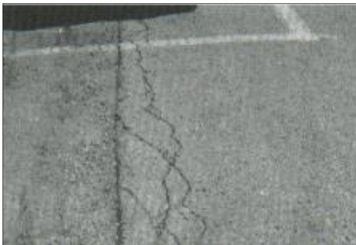
Figura N° 12: Grieta de borde
