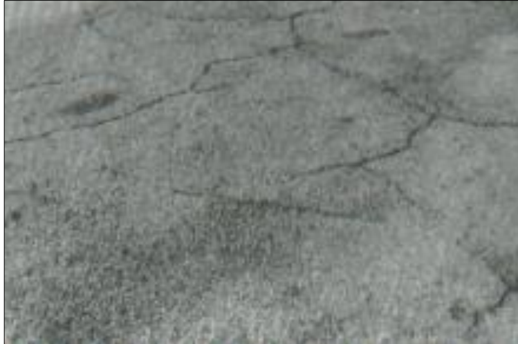
Figura N° 8: Agrietamiento de bloque
