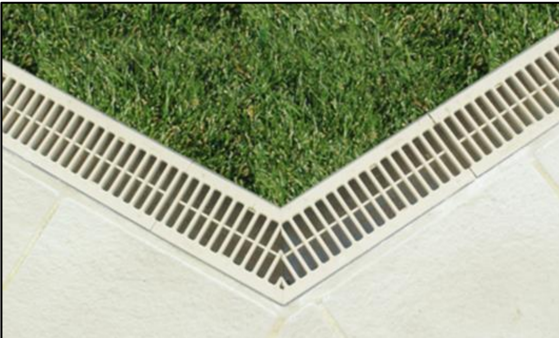
Figura 88. Canaletas en el piso
