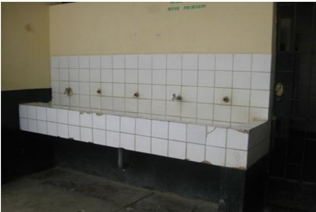
Lavaderos en los servicios higiénicos de los alumnos, se muestra las mayólicas rotas, sin mantenimiento y falta de enchapes en los muros laterales.
