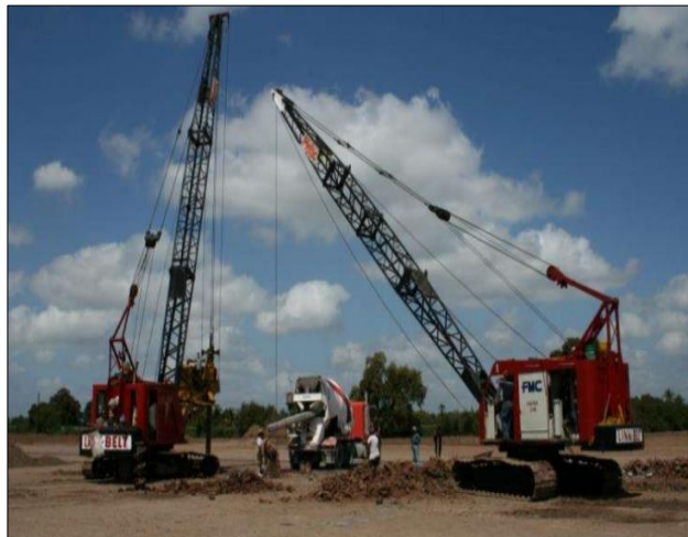
Figura N° 43: Planta de Etanol Sinaloa - México Fuente: Elaboración propia
