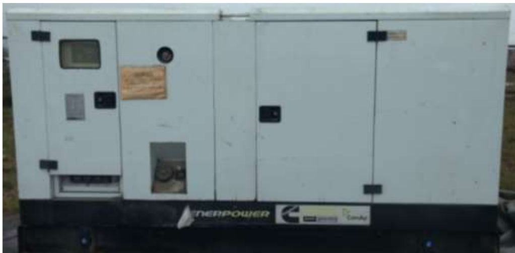
Figura 47 Generador eléctrico EnerPower. Fuente: Elaboración Propia.
