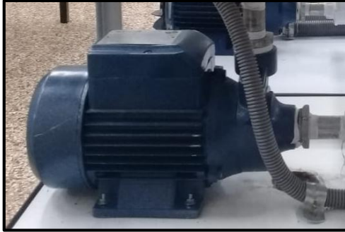
Figura N° 11: Bomba de agua
