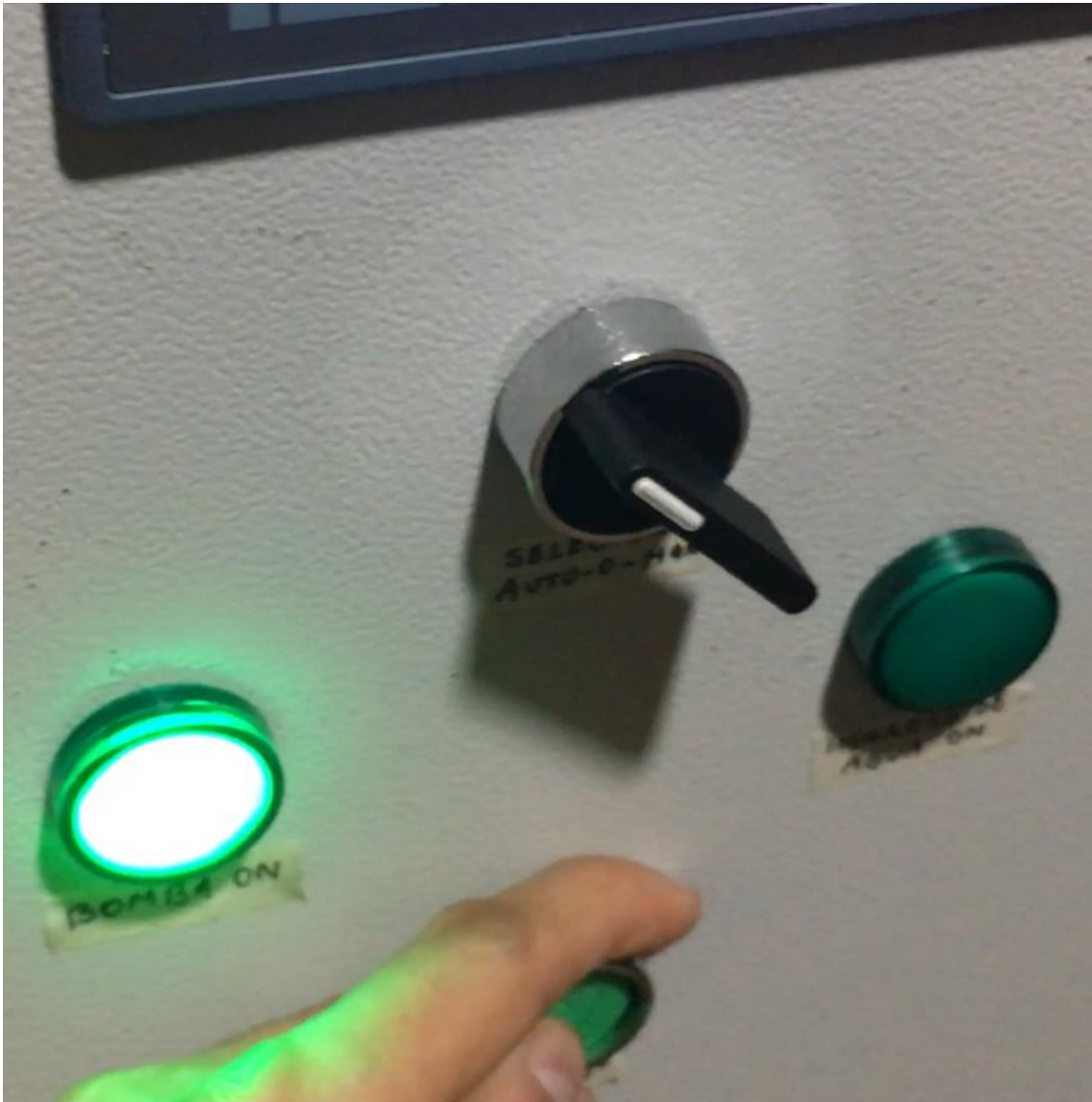
Figura N°83: Accionamiento de bomba de suministro Fuente: Elaboración propia
