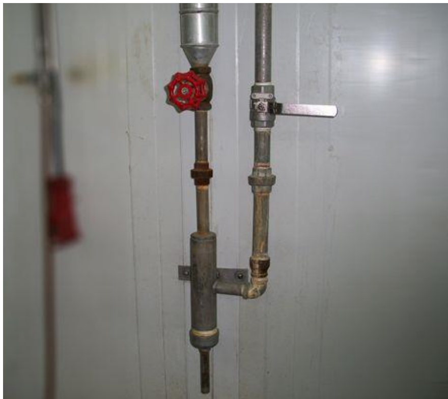
Figura N°82: Equipo mezclador rudimentario
