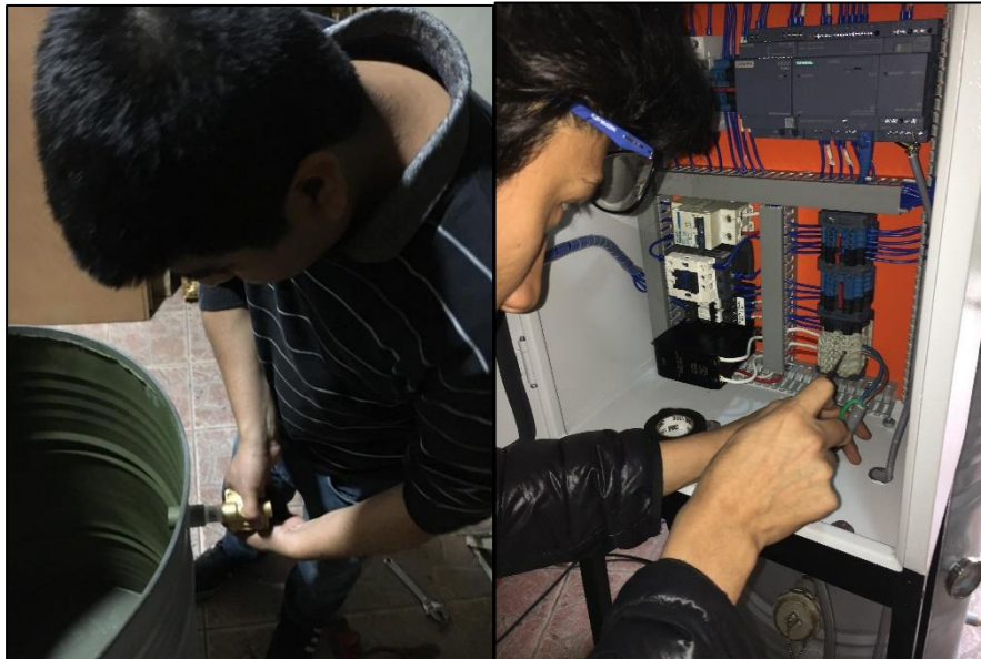
Figura N°64: Electroválvula y cableado de instrumentos Fuente: Elaboración propia
