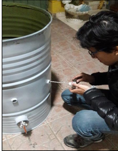
Figura N°62: Instalación de termómetro Fuente: Elaboración propia
