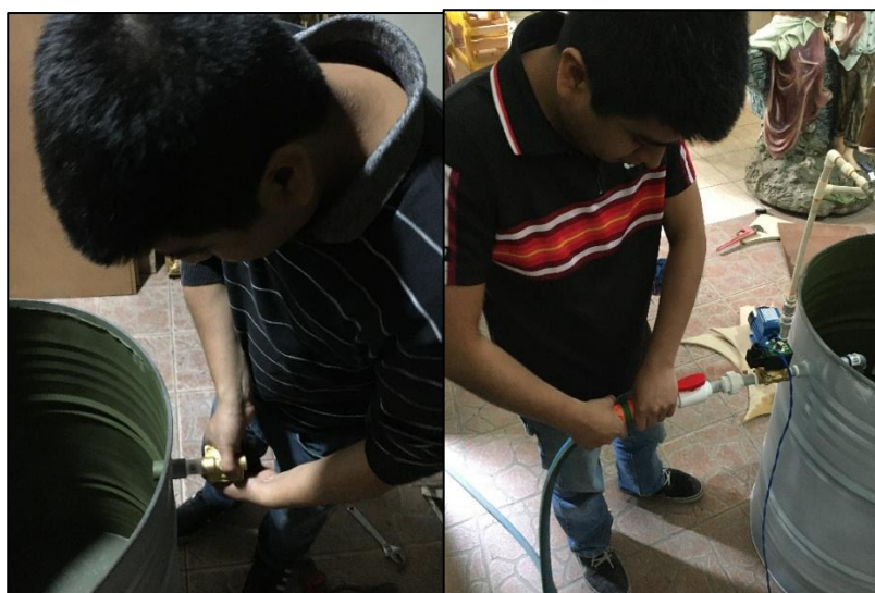
Figura N°54: Instalación mecánica de línea de ingreso de agua fría Fuente: Elaboración propia
