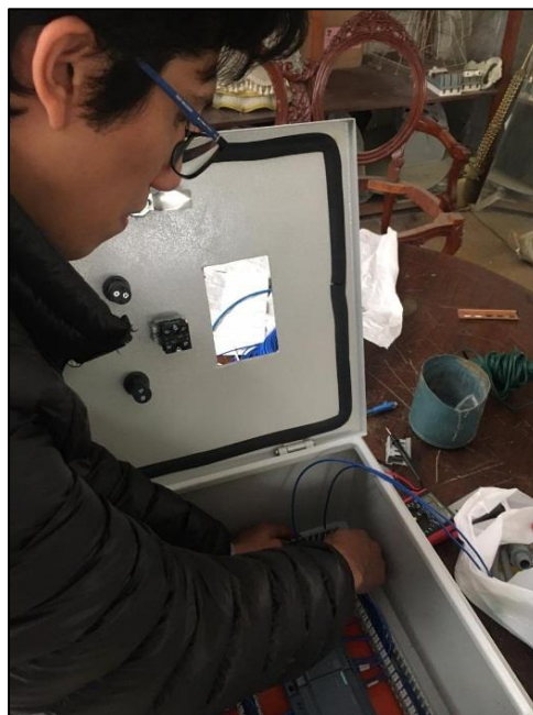
Figura N.º59: Cableado interno Fuente: Elaboración propia
