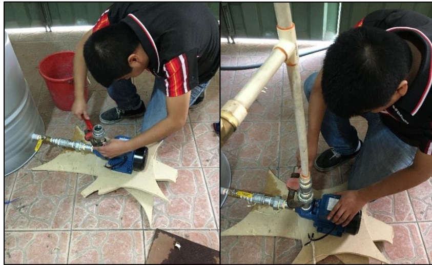
Figura N°53: Instalación mecánica de bomba y líneas de agua caliente Fuente: Elaboración propia
