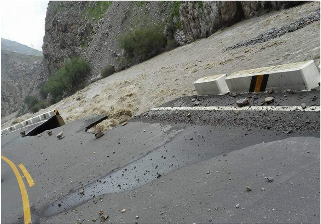
Figura N° 3: Destrucción de la carretera Churin – Oyon recién inaugurada. Fuente: Elaboración Propia.
