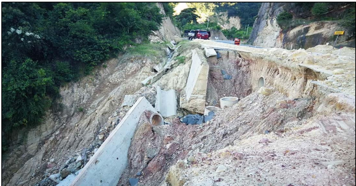
Figura N° 1: Carretera Montegudo Muyupampa (Bolivia); impacto de fuertes lluvias en marzo 2018.
