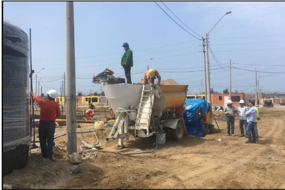
Figura 45: Conexión del tanque de agua a la planta dosificadora.
