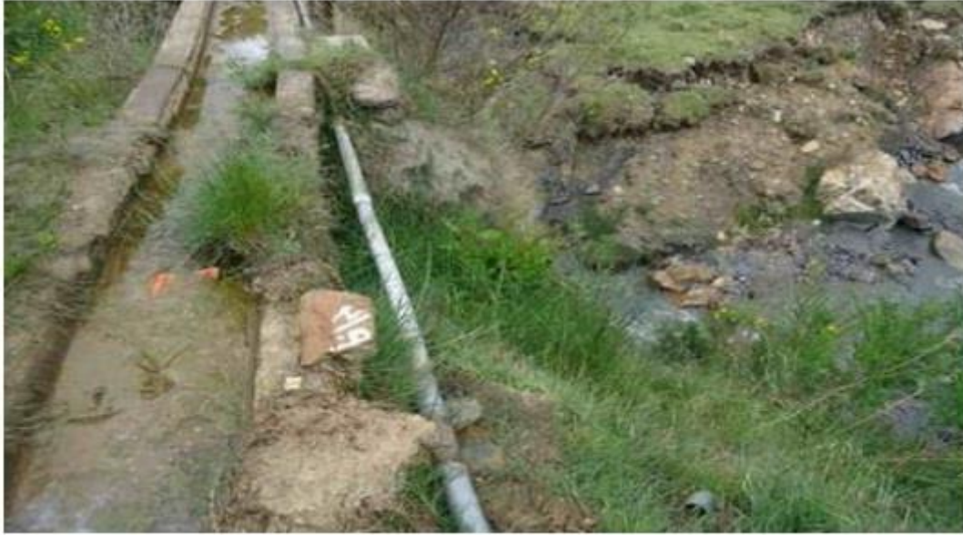
Figura 13. Captación de agua proveniente de cuerpos superficiales en Quispicanchi
