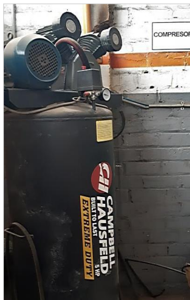
Figura 62. Limpiar – Zona de compresor (después) Fuente: Elaboración propia
