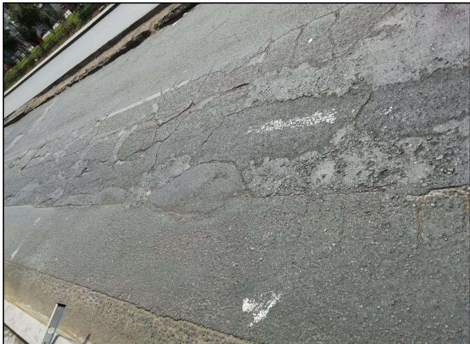
Figura N° 15: Falla Fisura de Contracción Térmica con gravedad 3 según VIZIR Fuente: Elaboración Propia
