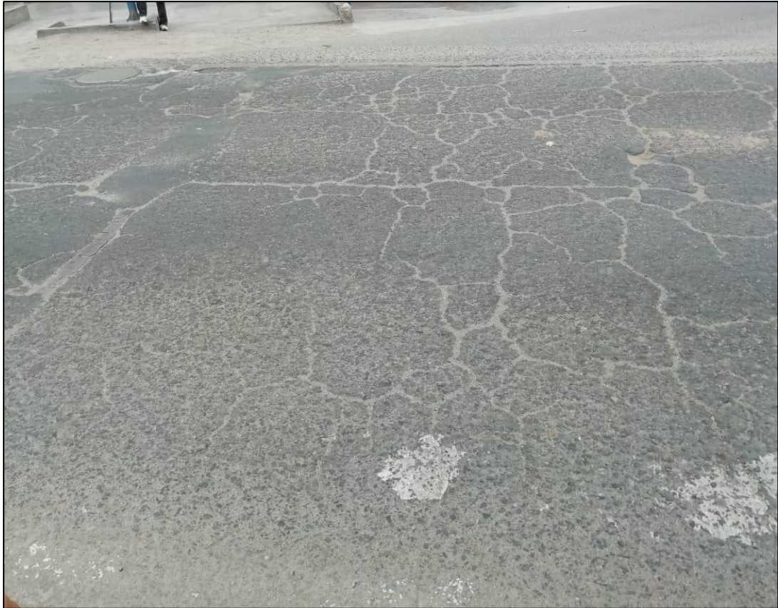
Figura N° 13: Falla Agrietamiento en Bloque con severidad media según PCI
