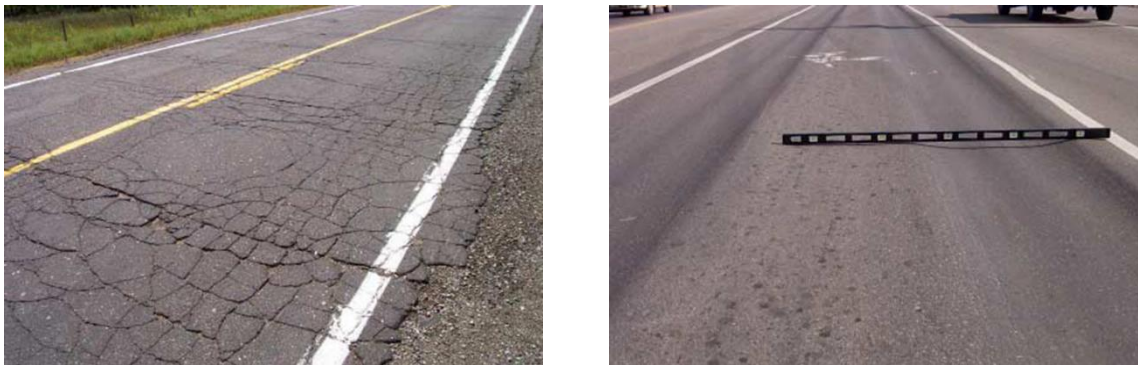
Figura 14: Tipos de deterioros comunes en pavimentos asfálticos: agrietamiento por fatiga y deformación permanente a nivel de subrasante Fuente: (Hernández, Garnica, & Solorio, 2010)
