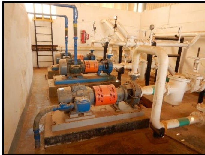
Figura N° 14 Sistema de Bombeo
