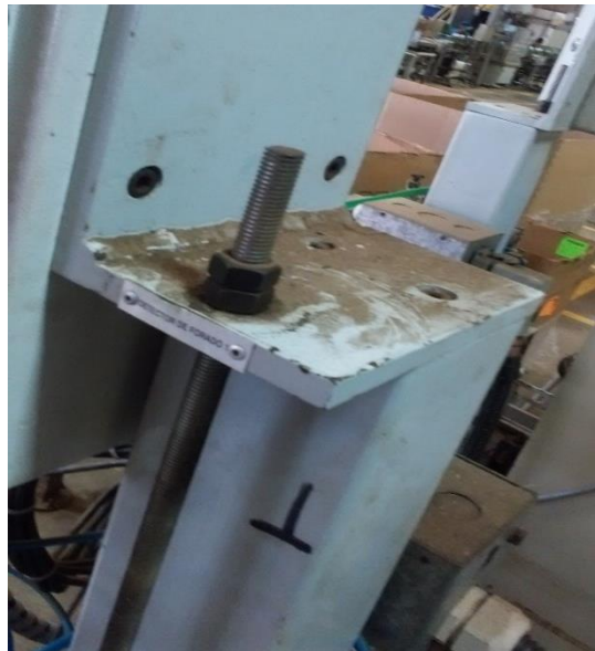
Figura 53. Pernos de aseguramiento de soportes
