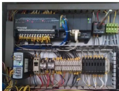
Figura 74. Tablero Eléctrico y componentes
