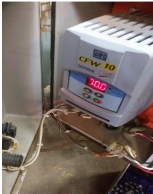
Figura 66. Variador de frecuencia al 70%
