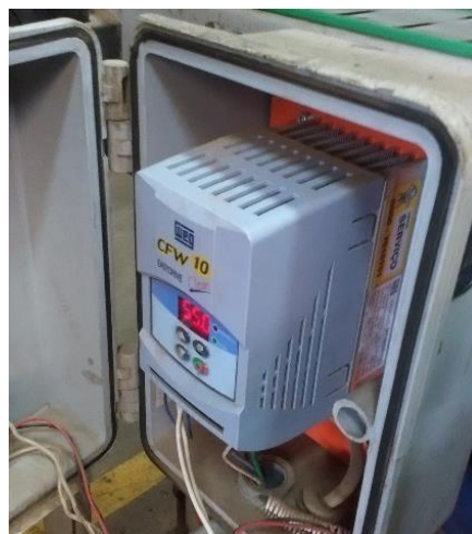
Figura 67. Variador de frecuencia al 55%
