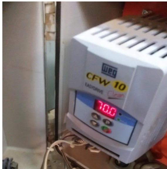
Figura 61. Variador de velocidad de la faja
