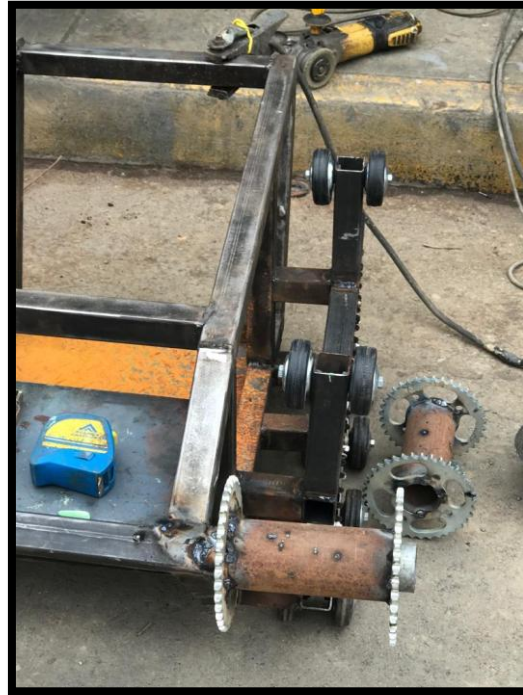
Figura 46: Carretes guías instalados
