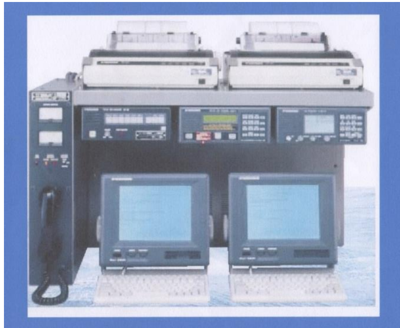
Figura 32: Equipos Terrenales Zona A3 - B
